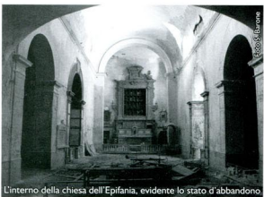
L'interno della chiesa dell'Epifania, evidente lo stato d'abbandono.
